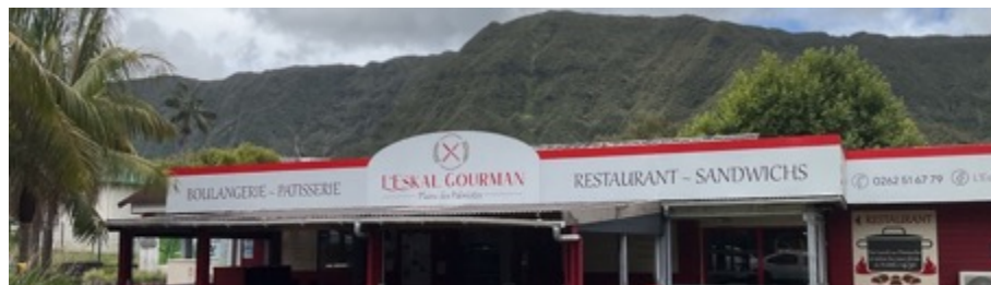
Enseigne sur toiture avec un panneau plein (illégal)
